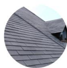
Plăci de fibrociment
