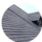
Plăci de fibrociment
