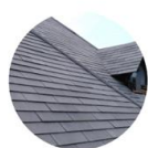
Plăci de fibrociment
