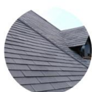
Plăci de fibrociment
