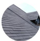
Plăci de fibrociment
