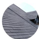
Plăci de fibrociment
