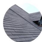
Plăci de fibrociment
