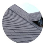
Plăci de fibrociment
